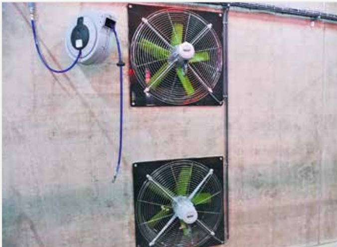
Bij de ventilatoren, maar eveneens in het eierlokaal en nabij de electrokasten vallen de haspels van de luchtslangen op om de tijdens de ronde alles netjes te houden.
