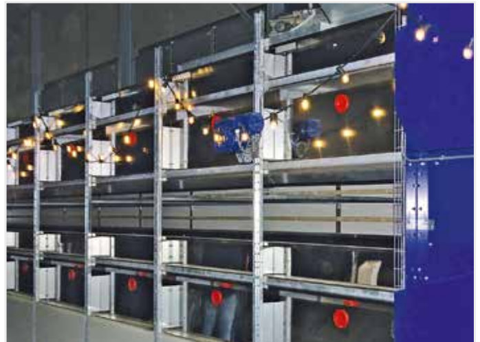
De imposante mestdroger achteraan de stal in de aangebouwde loods. De lampen zijn versiering omdat de opslagruimte tijdens de opendeurdag als ontvangstruimte dienst deed.
