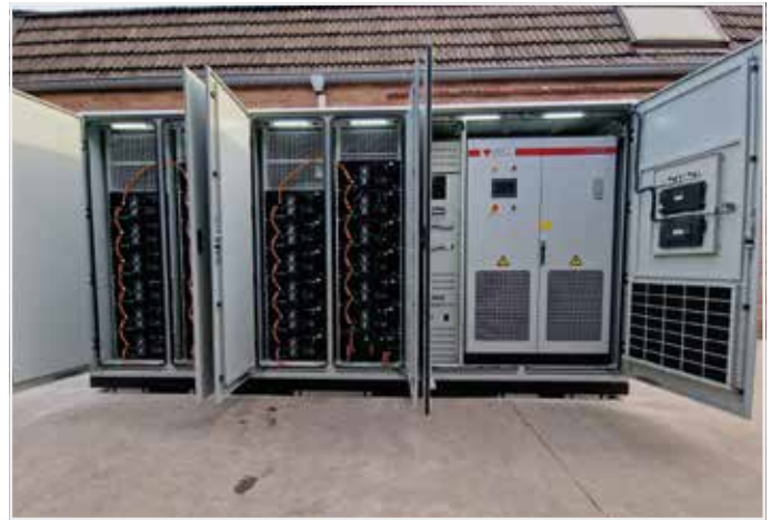
Batterij voor stroomopslag en bijhorende omvormer van "Posetron"
