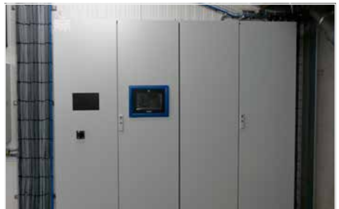
De grote centrale kast met alle regelapparatuur. Bemerkt dat er enkel 2 schermen zijn en geen enkele manuele knop. Alle instellingen worden via PC of smartphone gedaan.
