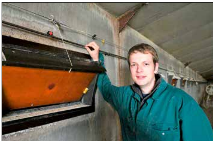
Ruben in de stal bij de geïnstalleerde nevelkoeling
