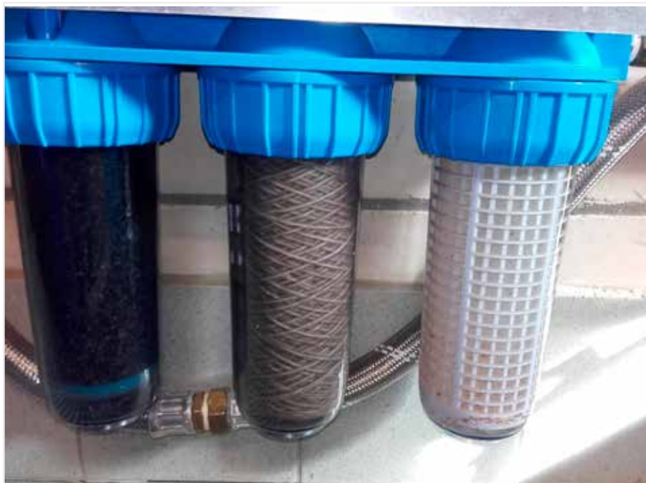
Op het PP zorgden drie filters (van rechts naar links: grofmazige filter, fijnmazig draadfilter, actief koolfilter) voor een eerste filtratie van het regenwater.
