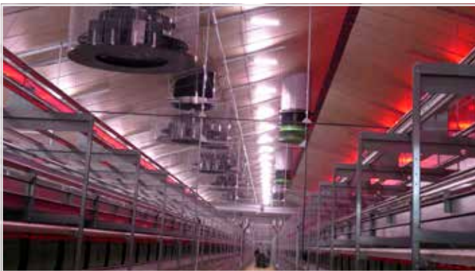
Een indrukwekkende lijn met 10 grote ventilatoren voor afzuiging (links) en 10 voor de inlaat van de lucht zorgen voor gelijkdrukventilatie.
