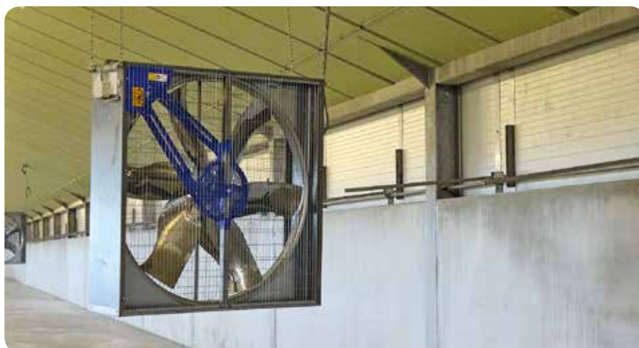
Over de ganse lengte van de stal is in de zijwanden een grote afsluitbare zone als luchtinlaat voorzien. Vier circulatieventilatoren langs weerszijden van de stal zorgen voor een homogene luchtstroom.
