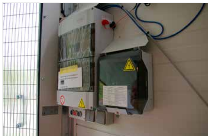
Iedere unit is uitgerust met een volwaardige elektrische installatie.
