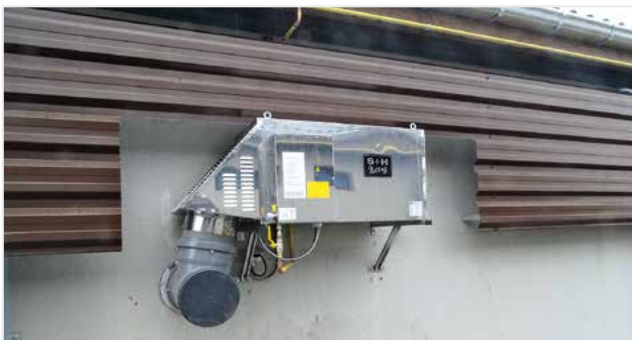
Vier Nolting gasbranders in een zijgevel zorgen voor de verwarming.
