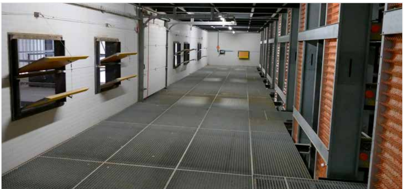
De in 2013 opgebouwde stal bestaat uit drie etages met telkens drie niveaus kippenverblijven. Bemerk de verticale eiertransportbanden en de luchtinlaten die dienst doen wanneer de tunnelventilatie in werking treedt.
