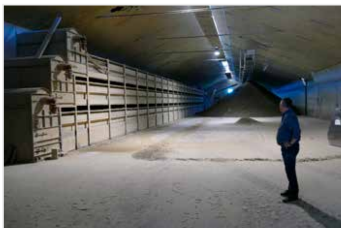
In de vroegere legkippenstal is nu de imposante mestdroger geïnstalleerd en wordt de gedroogde mest gestockeerd.
