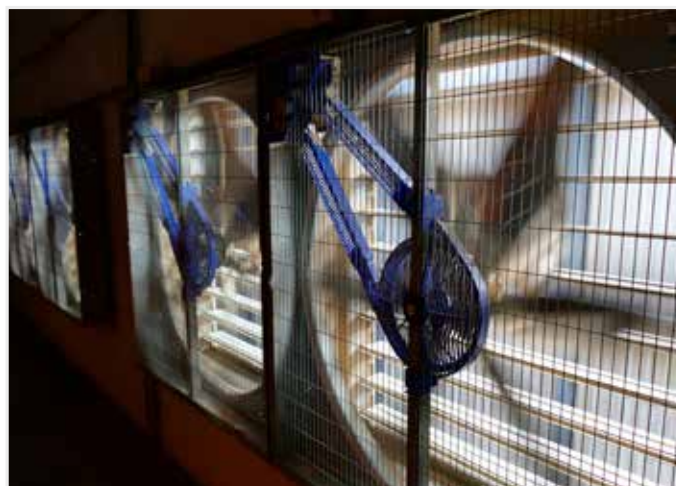
Na de hittegolf van vorige zomer werden de afzuigventilatoren vervangen door nieuwe ventilatoren die 6 schoepen hebben en waar de kleppen vlotter van opengaan.
