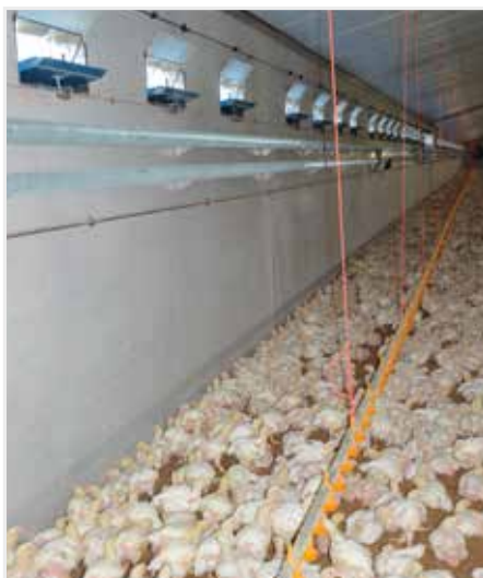
De stallen zijn uitgerust met spiraflex buizen voor de verwarming en nevelkoeling met 2 nozzels boven iedere luchtinlaat.
