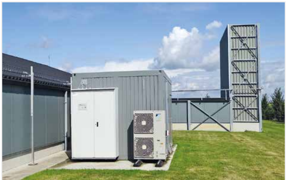
In deze container is de meetapparatuur ingebouwd waar o.a. continue de ammoniakconcentratie bij 12 meetpunten (inlaten, in de stal en bij de uitlaten) opgevolgd wordt.
